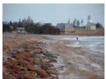
Domages causés par une onde de tempête, chaussée de l'Île Panmure, Î.-P.-É.
