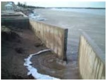
Bris de structure de contrôle de l'érosion, Bathurst, N.-B.
